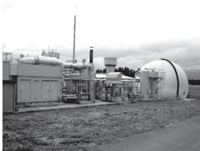
バイオガスプラント（メタン発酵）
